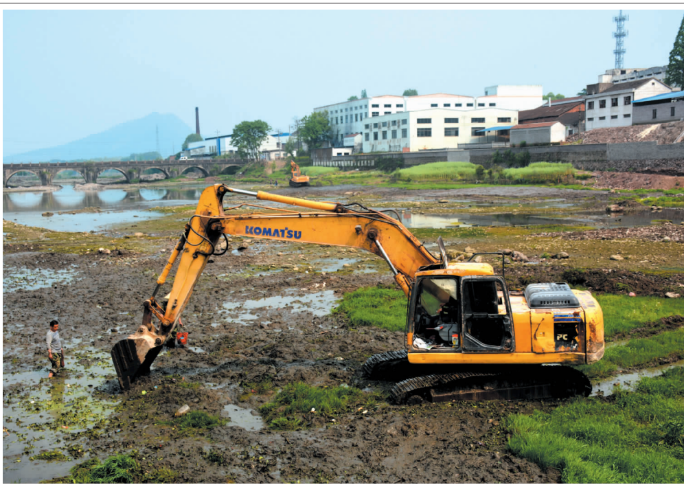
近日，王宅镇对麻阳港1.5公里的河道进行清淤。同时，为深入开展“五水共治”工作，改善水环境，该镇积极推进禁养区养殖场拆除工作，截至目前，已拆除养殖场33家，面积7295平方米。图为麻阳港河道清淤现场。 李正 摄
